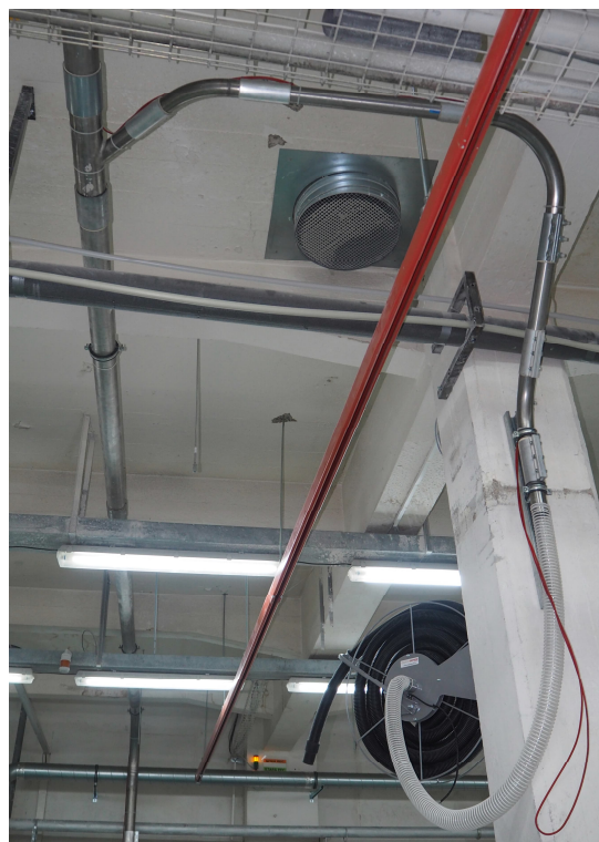
Potrubní rozvod pozink
