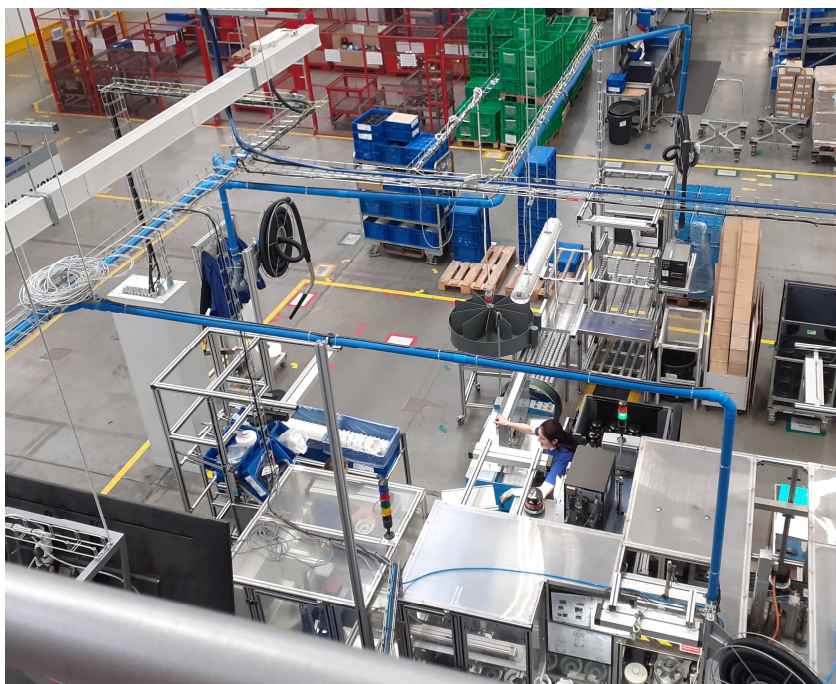
Potrubní rozvod PVC
