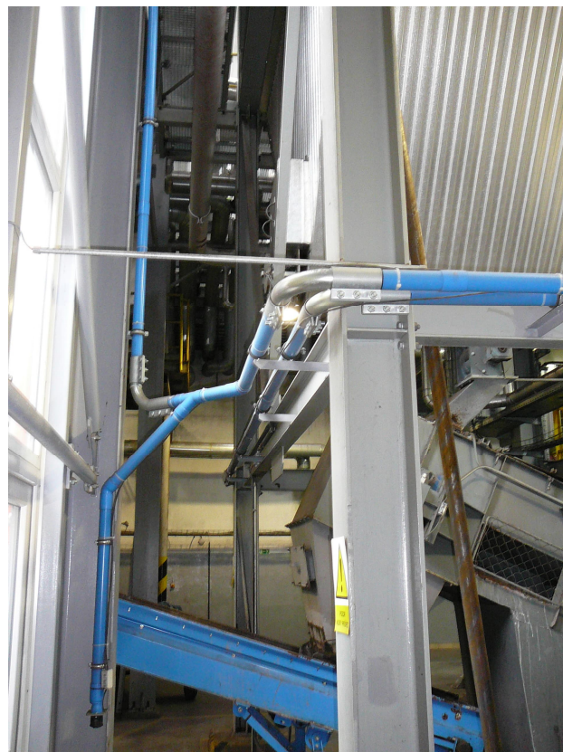
Potrubní rozvod kombinovaný
